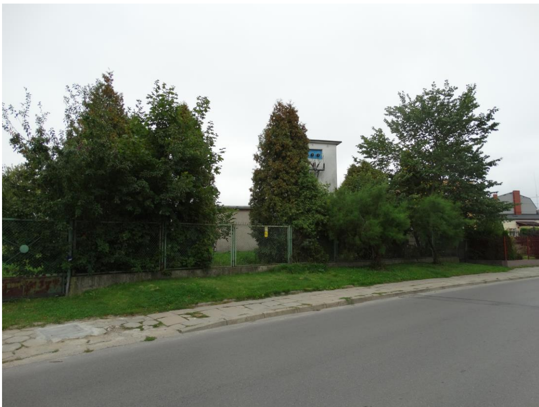
Wgląd na stację transformatorową na terenie działki Nr 659/1 z ul. Niepodległości w kierunku południowym.
