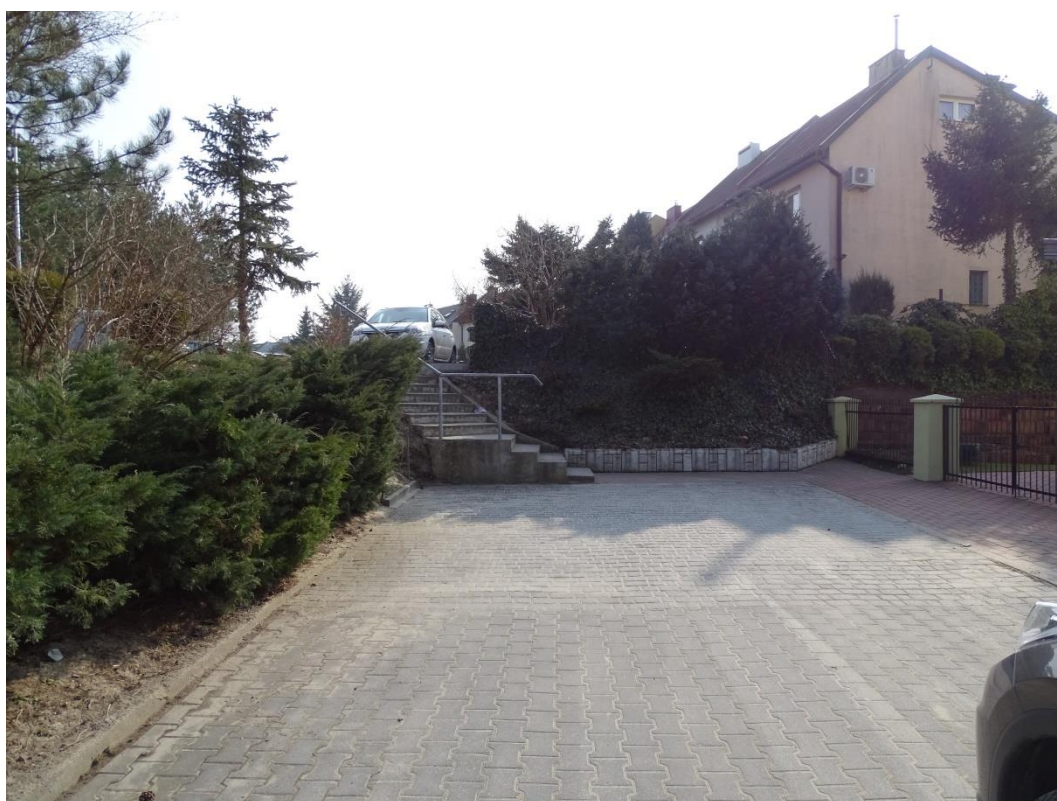
Zdjęcie Nr 136. Nieciągły odcinek jezdni w środkowej części ulicy.
