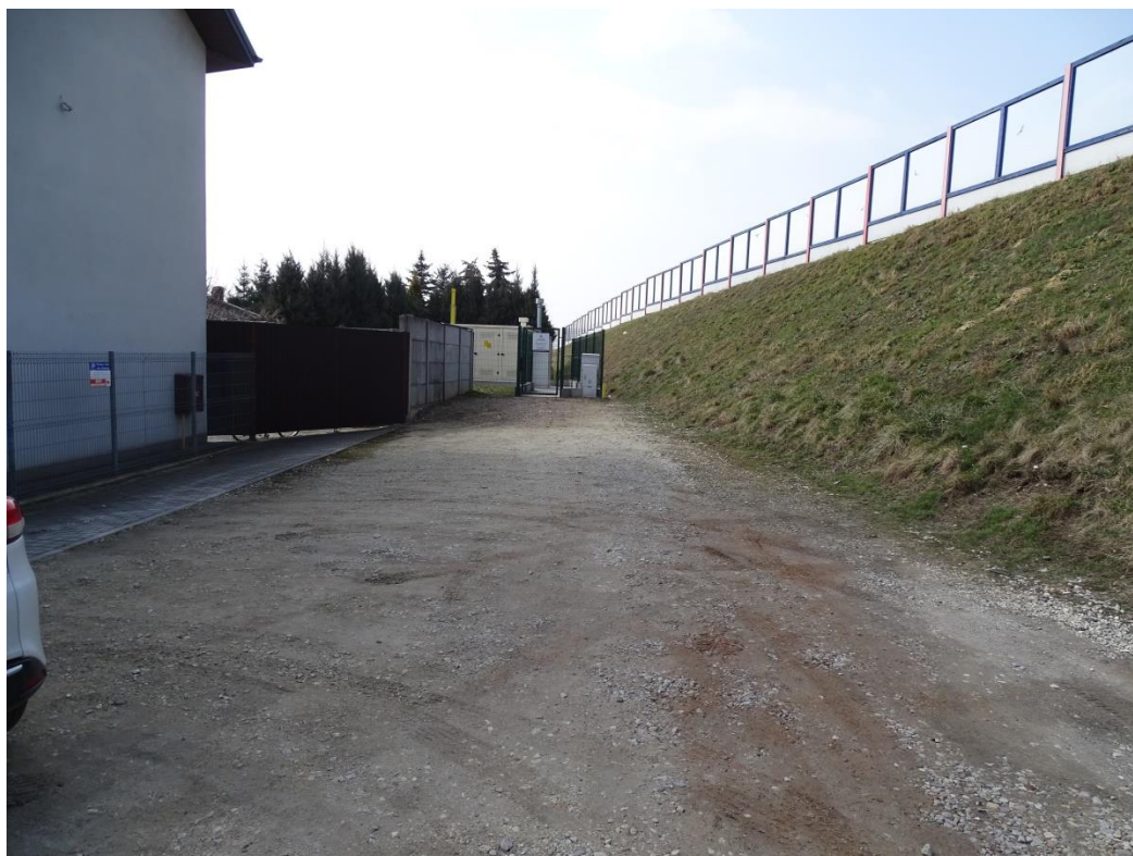
Zdjęcie Nr 61. Stacja redukcyjna gazu, wgląd od strony wschodniej.
